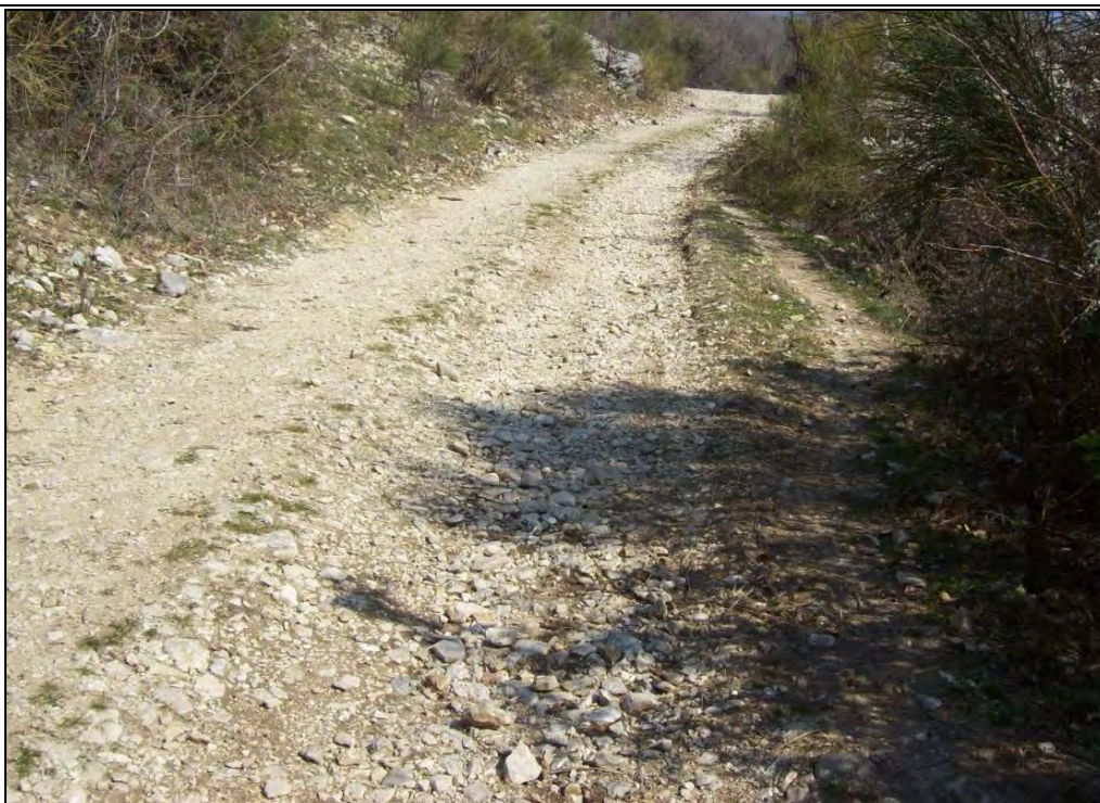
Tipica pista camionabile dove occorrono opere di ripristino.
