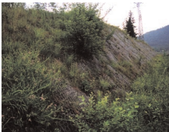
Foto 18.33 - Scarpata in roccia arenacea a 45° con rivestimento vegetativo in rete metallica e stuoia organica. Stazione FS Tarvisio - Boscoverde. Foto G. Sauli - Giugno 2003
