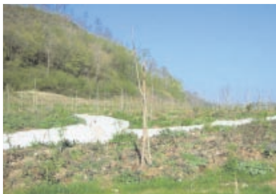
Foto 18.17 - Rivegetazione area boscata rilevato galleria Pileggi. Ben visibile un fosso di guardia realizzato in cls al posto di geostuoia tridimensionale bitumata inerbata prevista nel progetto 3a corsia Autostrada Orte-Fiano. Foto P. Cornelini
