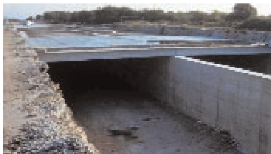
Foto 18.80 - Copertura artificiale di trincea per continuità faunistica. Loc. Prosecco (TS). Superstrada Trieste-Lisert - Foto G. Sauli
