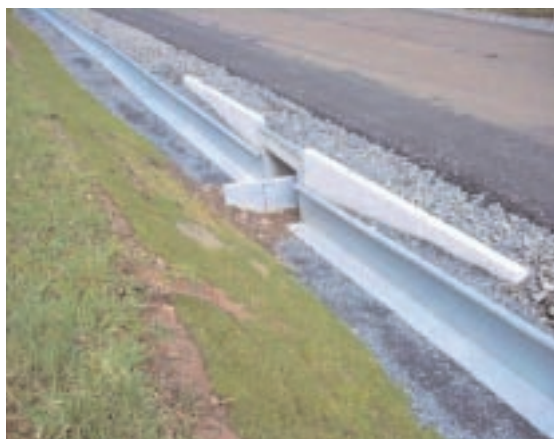
Foto 18.89 - Particolare provvedimento di svio. Foto Maibach
