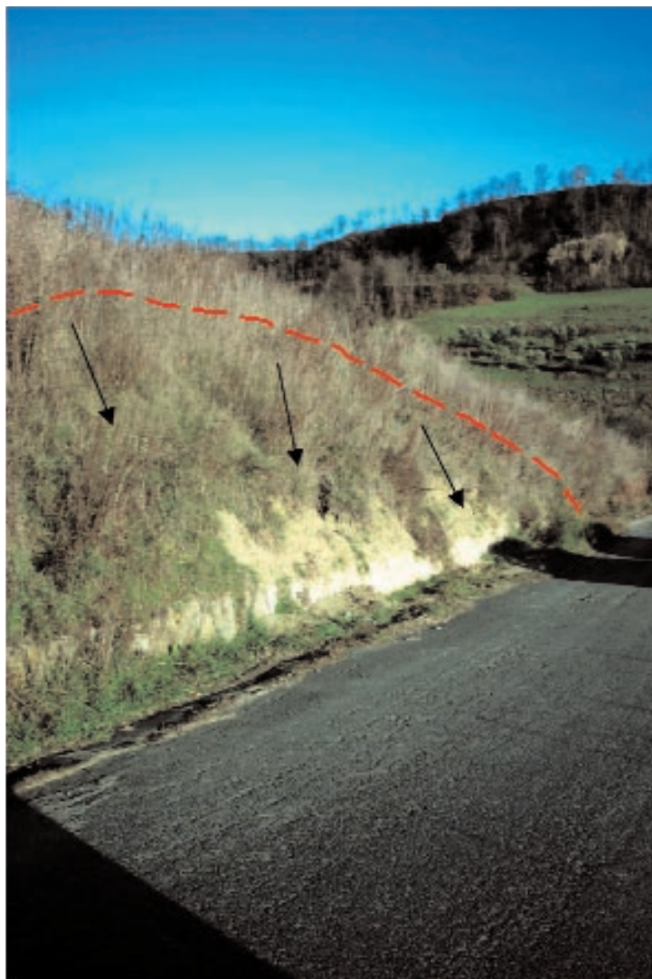
Scarpata ante-operam con linea di frattura e direzione del movimento franoso
