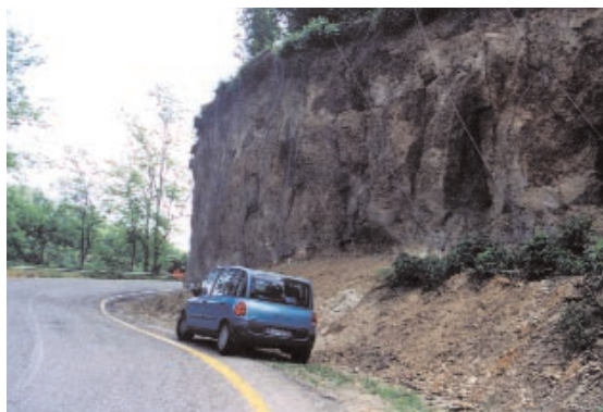
Foto 18.38 - Scarpata in roccia verticale, rivestita in rete metallica. S.S. per Bagnoregio (VT). Foto G. Sauli
