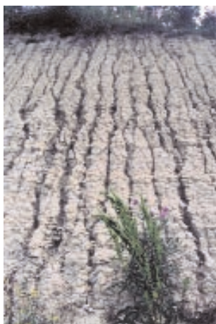
Foto 18.19 - Inizio di solchi di erosione su scarpate non rivegetate in trincea in litologia sciolta. Foto G. Sauli - 3° corsia Autostrada Orte-Fiano
