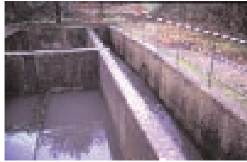
Foto 18.78 - Vasca di prima pioggia. Autostrada Brema - Hannover. Foto G. Sauli
