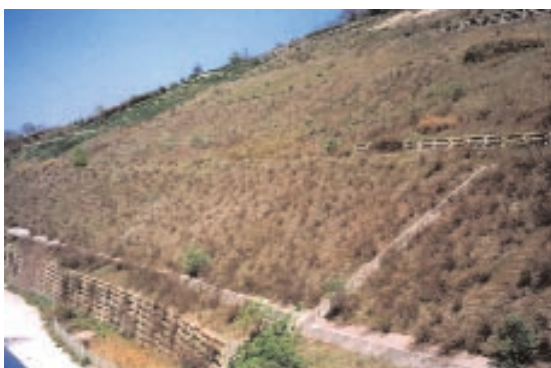
Foto 18.28 - Scarpata in sabbia presso svincolo di Orte stabilizzata con mantellate, sparizione totale di Mesembryanthemum e crescita spontanea di Inula viscosa. 3ª corsia Autostrada Orte-Fiano. Maggio 2002 - Foto G.Sauli
