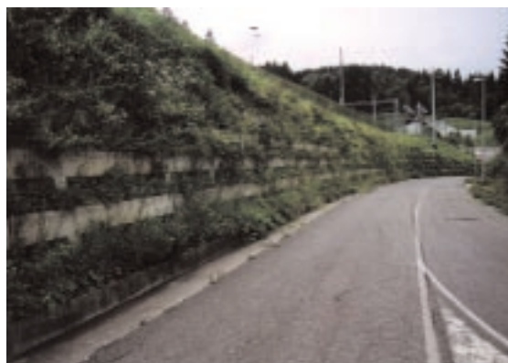
Foto 18.46 - Muro cellulare rinverdito. Stazione di Tarvisio Boscoverde (UD). Giugno 2003 - Foto G. Sauli
