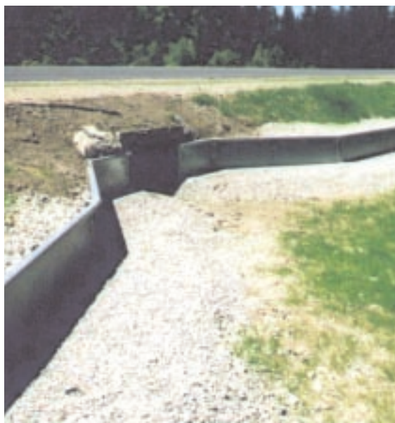
Foto 18.88 - Particolare provvedimento di svio. Foto Maibach
