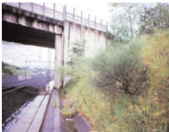
Foto 18.37 - Scarpate in trincea in argilla stabilizzate con rivestimento in rete metallica e stuoia organica dopo insuccesso del trattamento con sola idrosemina. Arezzo-Ferrovia direttissima Firenze-Roma, Foto P. Cornellini
