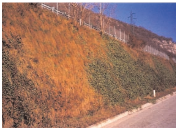
Foto 18.44 - Terra rinforzata rinverdita, a 10 anni dall'intervento. Pian di Vedoia. Autostrada Vittorio Veneto. Foto G. Sauli
