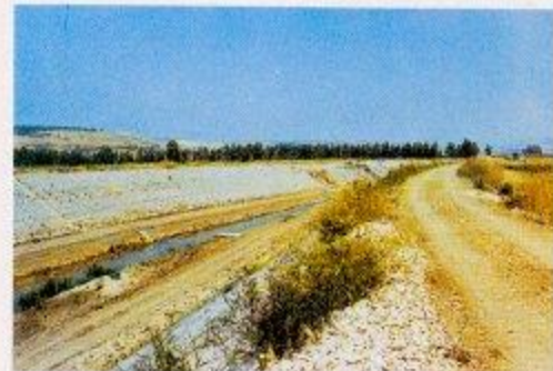
Fiume Belice (Agrigento): canalizzazione con rivestimento flessibile della sponda della ditta Maccaferri
