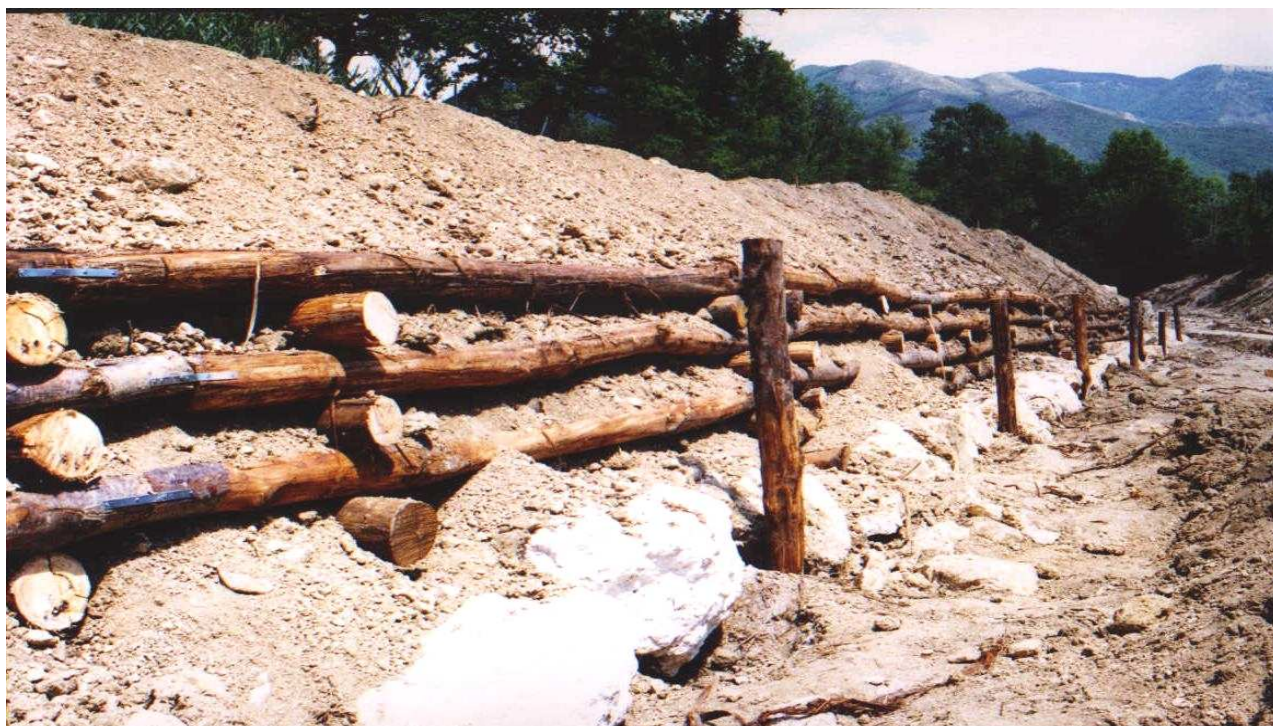
Figura 1: realizzazione non ottimale di un'opera di ingegneria naturalistica (palificata doppia) nel cantiere sul Rio Saetta. Tra gli elementi negativi, la dimensione ridotta del pietrame a protezione del piede e del legname utilizzato, l'assenza di talee e la mancanza di un geotessuto o di pietrame sul paramento interno per evitare la fuoriuscita del terreno di riempimento. Foto luglio 1999
