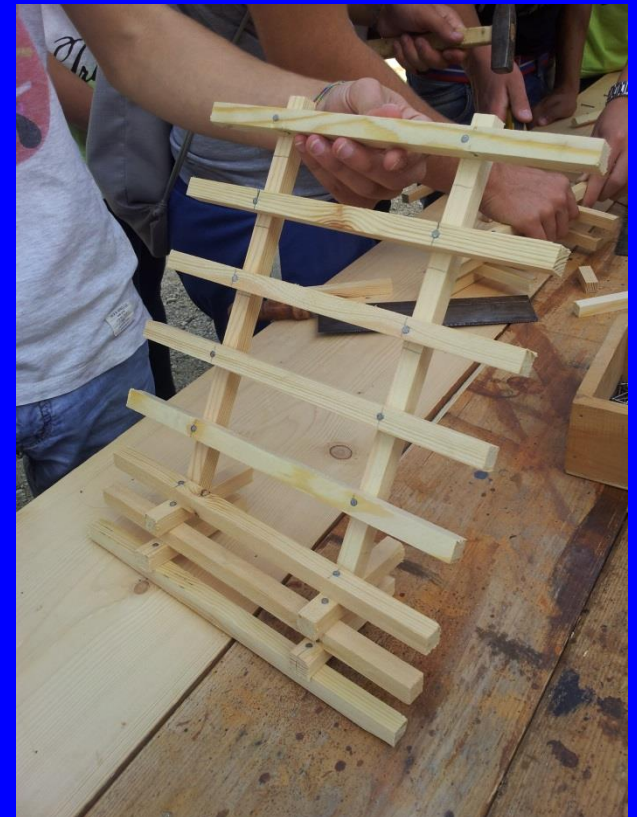
MINI CANTIERE DIDATTICO DI INGEGNERIA NATURALISTICA presso l'Istituto Costruzioni, Ambiente e Territorio "Bruno Tallini" di Formia (LT) 2014
