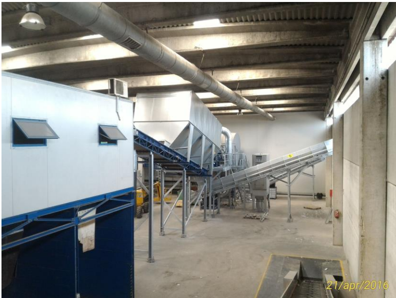
Foto 2 - linea di trattamento e particolare del sistema aeraulico
