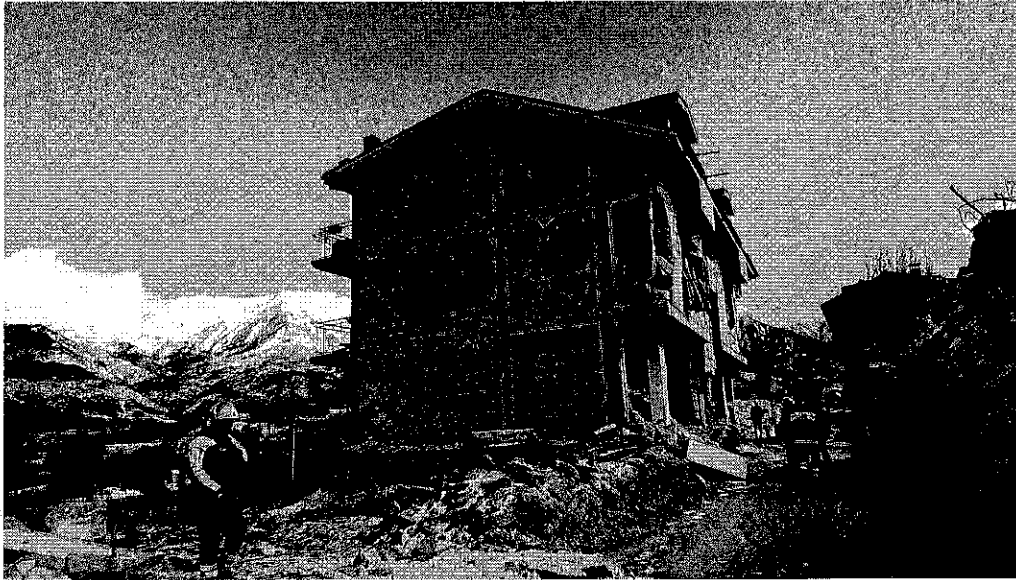
08) edificio gravemente lesionato (F. 59 p.lla 944, 17 e 18) Via dei Bastioni
