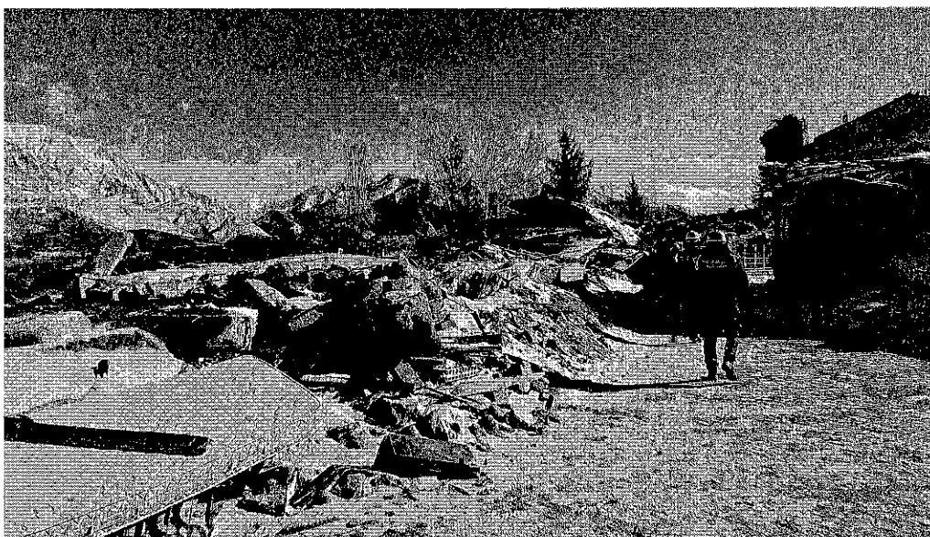
10) e 12) gruppo di edifici crollati F. 59 p.lle 595, 703, 596 e 841 Via dei Bastioni
